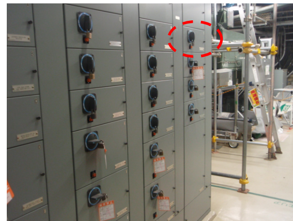
発煙した電源盤
