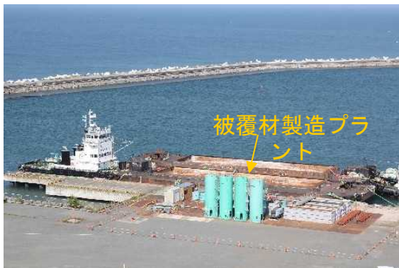
当所構内（物揚場）の被覆材の製造プラント
