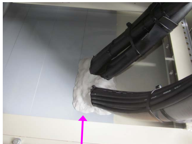
小動物侵入対策後の状況 (空冷式ガスタービン発電機車)
