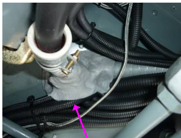
小動物侵入対策後の状況 (電源車)
