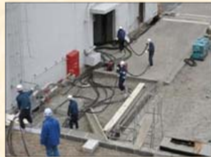
被災当時（平成23年3月13日）、電源復旧のため、協力企業の皆さまと当所所員総勢約200名で総延長約9kmの仮設ケーブルを布設しました。
