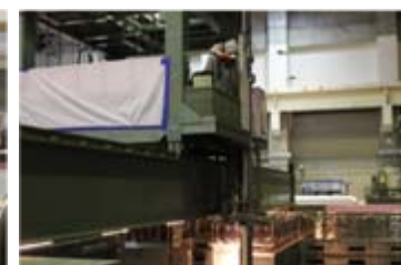
燃料交換機上 (平成25年10月16日撮影)
