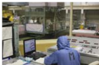
燃料交換機操作室 (平成25年10月16日撮影)
