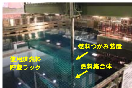
使用済燃料貯蔵ラックへの収納 (平成25年10月16日撮影)
