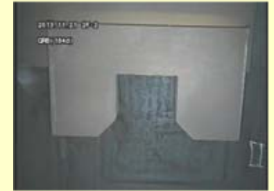
蒸気乾燥器耐震用ブロック (平成25年11月21日撮影)
