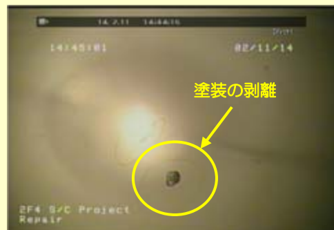
圧力抑制室内の壁面 (平成26年2月11日撮影)
