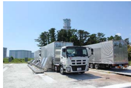
構内の高台に配備したガスタービン発電機車
