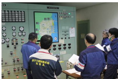
中央制御室でのデータ表示確認
