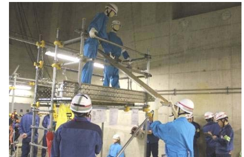
危険箇所をチェックしている様子
