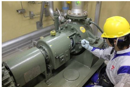
現場パトロールで機器の状態を確認
