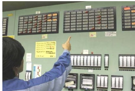
冷却システムの警報表示の確認
