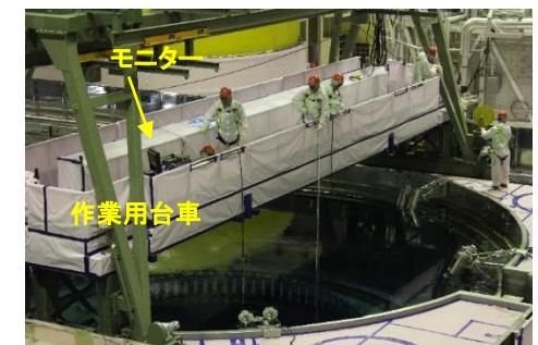
写真は1号機で行われた炉内構造物点検時の様子(2014年8月7日撮影)
