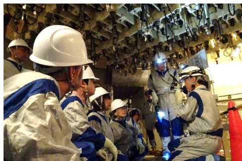
原子炉格納容器内（压力容器下部）
