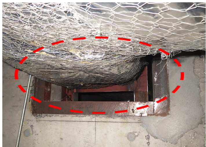
3・4号機コントロール建屋 3階中央操作室前ハッチエリア
