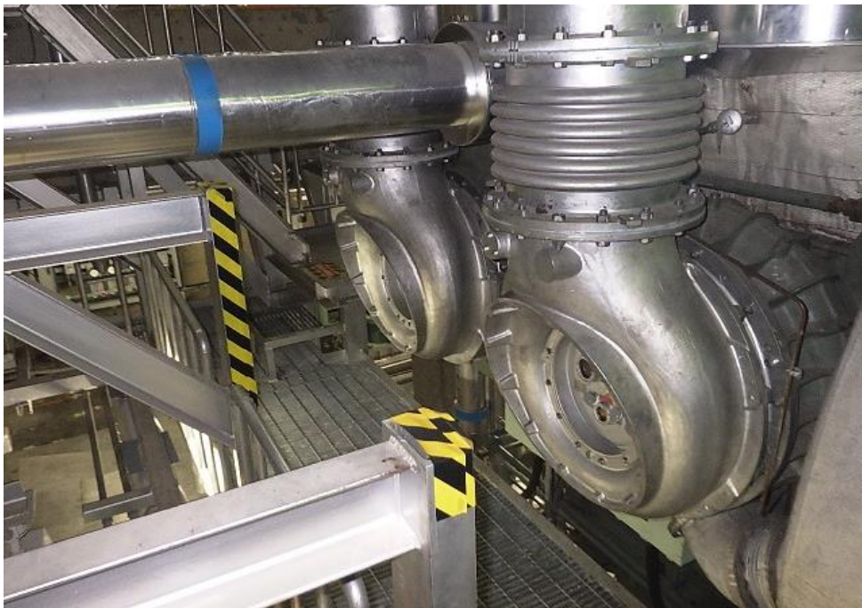
3号機非常用ディーゼル発電機（B系）過給機
