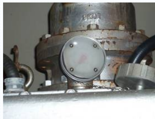
電動弁開度計アクリルカバーの変色 (平成24年3月13日撮影)
