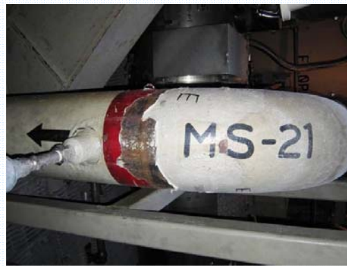
主蒸気系配管の塗装剥離 (平成24年3月13日撮影)
