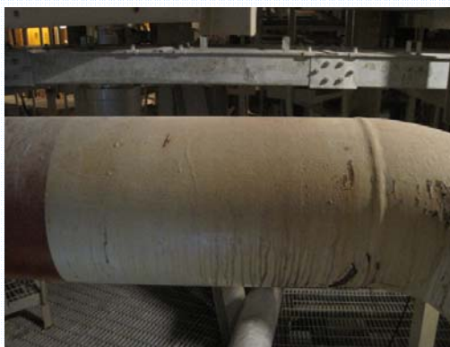
グレーチングの亜鉛メッキ剥離(白い粉) (平成24年4月17日撮影)
