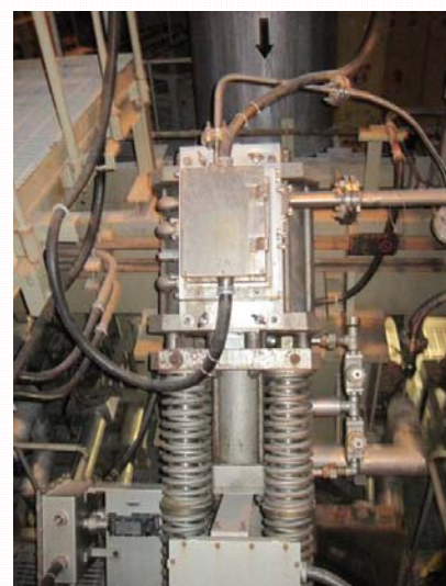
④主蒸気隔離弁 （平成24年4月17日撮影）
