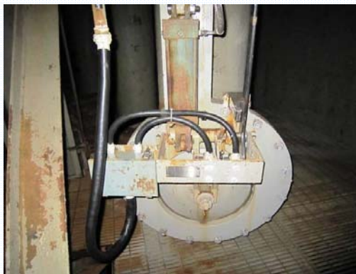
真空破壊弁表面の錆 (平成24年4月17日撮影)
