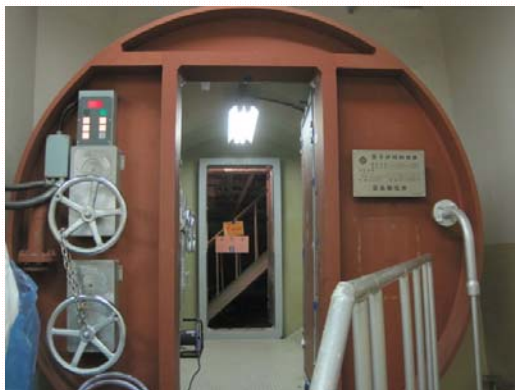
①原子炉格納容器入口（所員用エアロック） （平成24年5月10日撮影）
