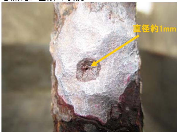
漏えい箇所(拡大)
