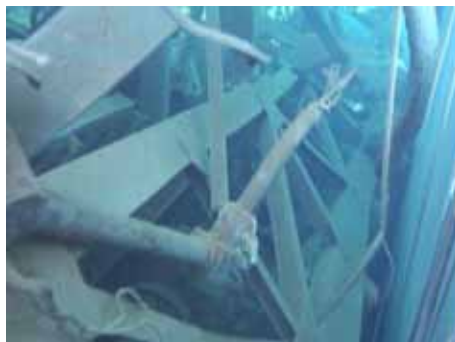
画像 : 燃料交換機の歩廊部の状況
