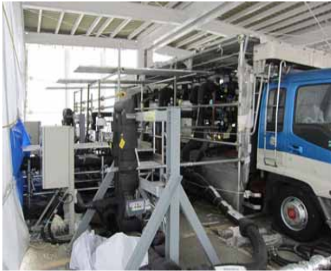
< 常用高台炉注水ポンプ >
