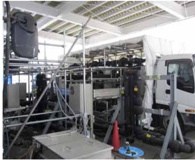
< 非常用高台炉注水ポンプ >
