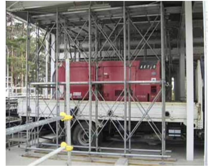
< 非常用ディーゼル発電機 >
