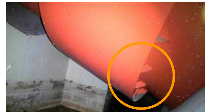
ベント管ベローズカバー下部
