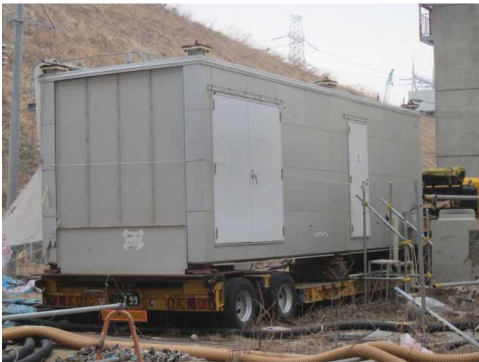
コンテナ側面 仮設 3 / 4号M / C 入口
