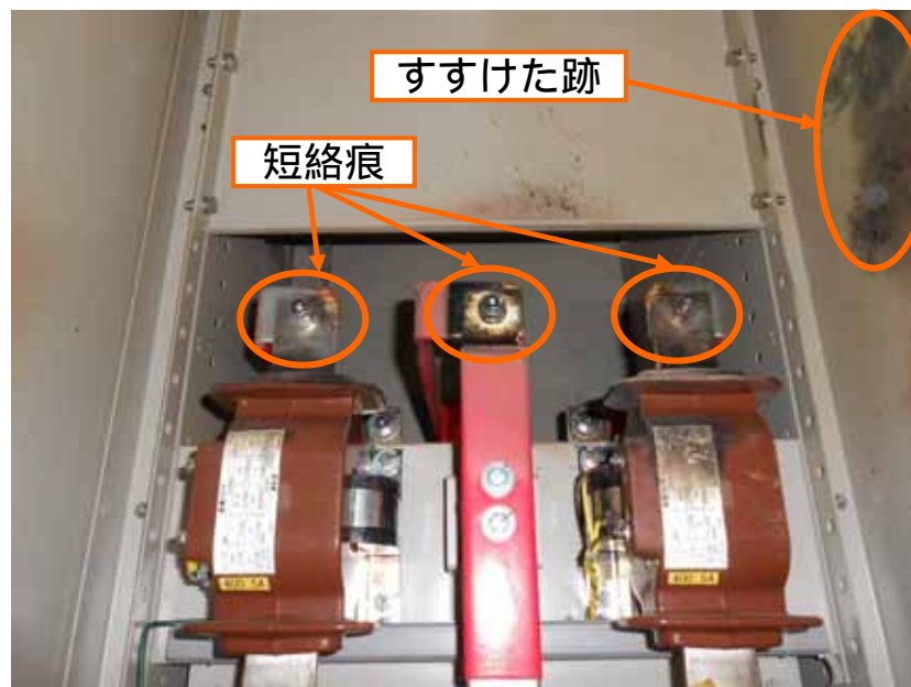
写真 短絡後の盤内
