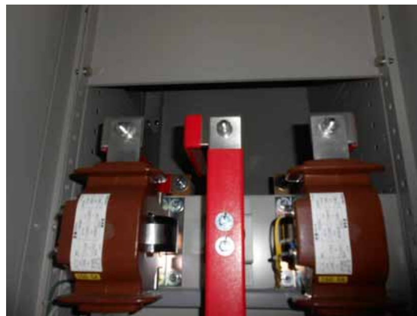
写真 健全な盤内
