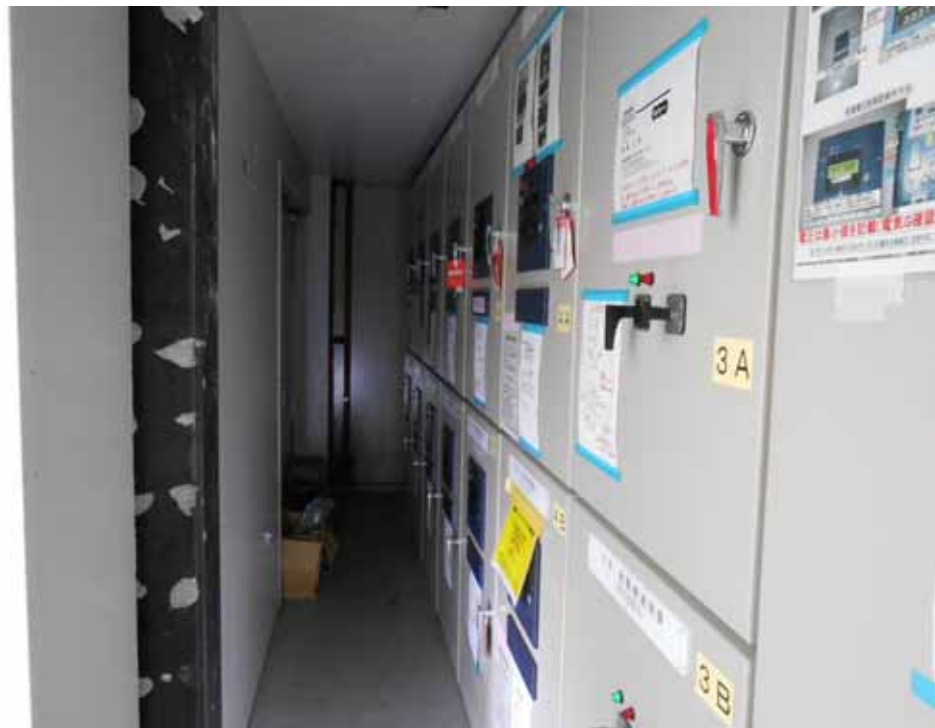
仮設 3 / 4号M / C 前面 (コンテナ内部)
