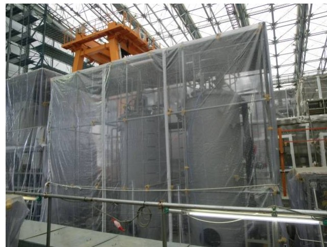
吸着塔 (処理カラム) 平成25年3月27日撮影
