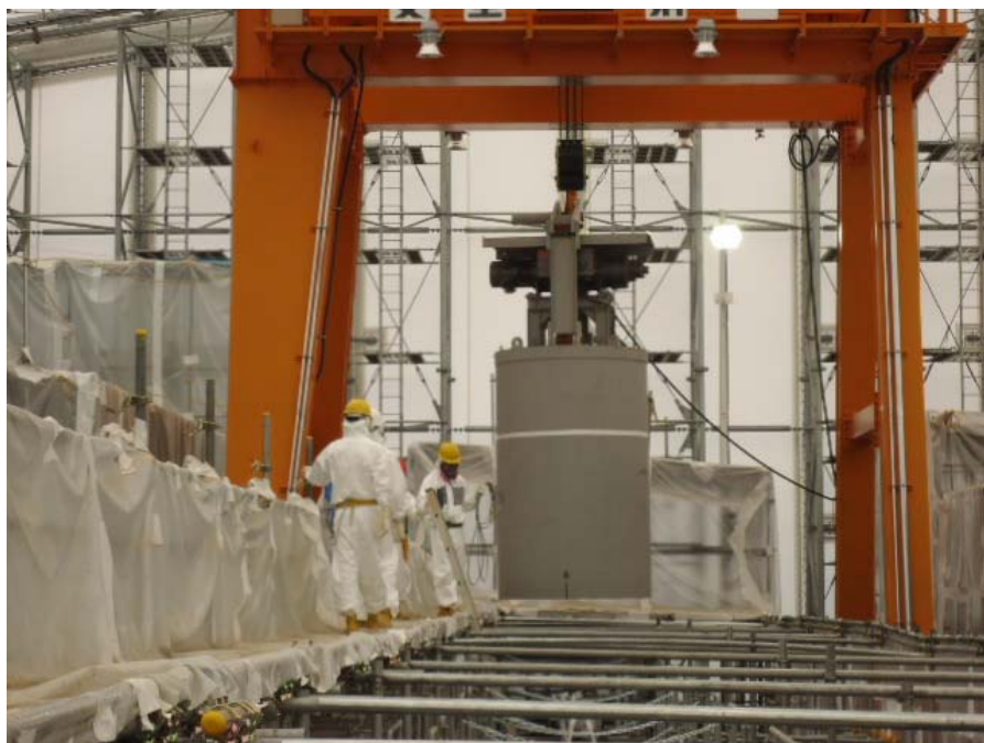
多核種除去設備エリア
