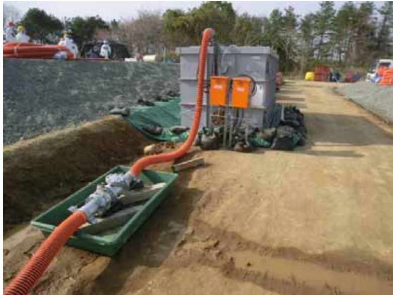
中継タンク～仮設ライン
