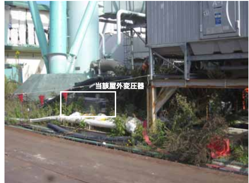
写真1：福島第一原子力発電所2号機使用済燃料プール代替冷却系用の屋外変圧器
