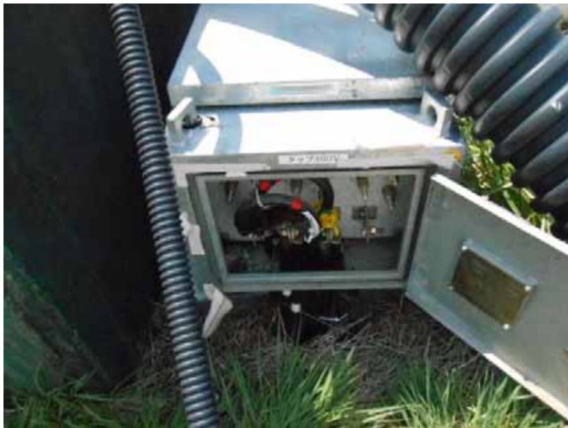
写真2：屋外変圧器（外観）
