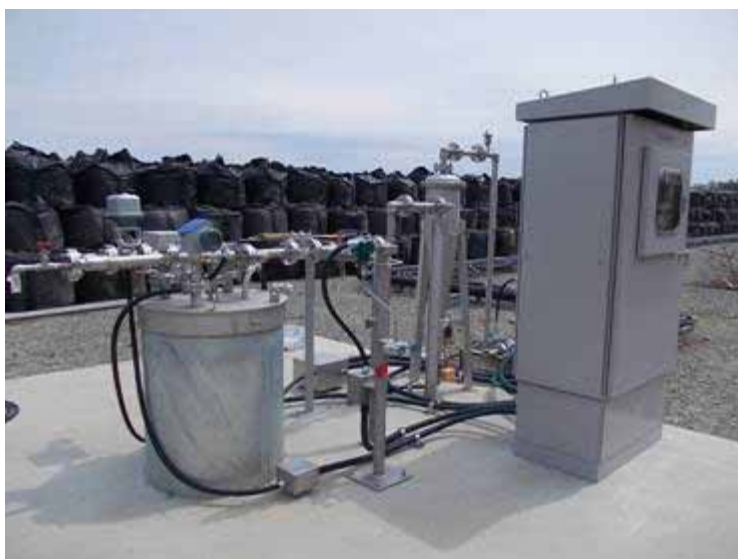
No.11揚水井および揚水・移送設備
