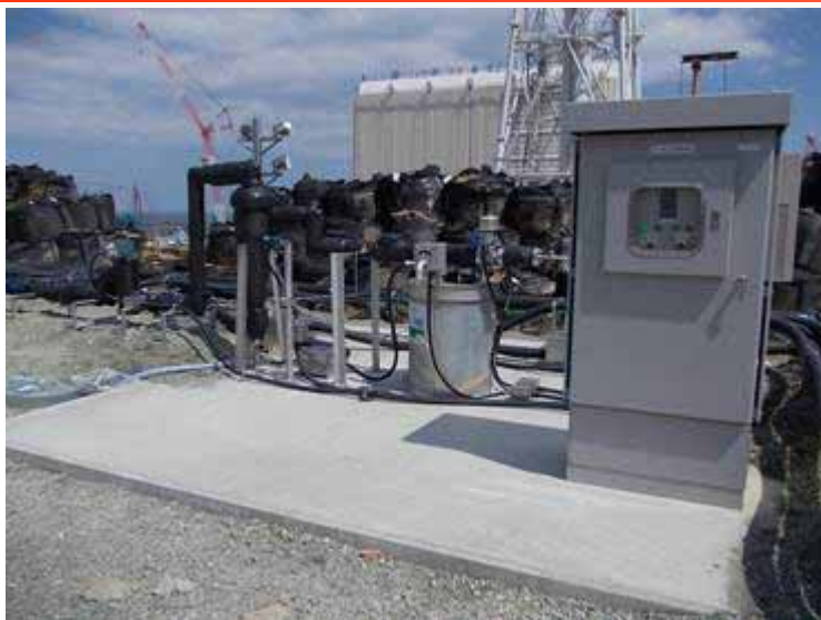
No. 3揚水井および揚水・移送設備
