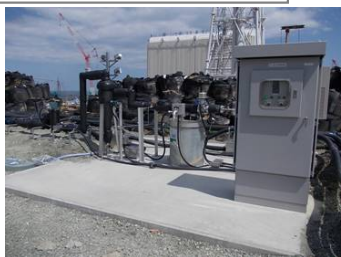
揚水井は密閉構造を採用
