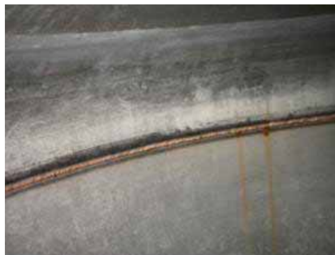
吸着塔 1 3 A タンク内上部溶接部（ 若干の腐食あり ）
