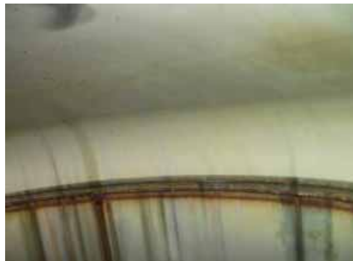
吸着塔 8 A タンク内上部溶接部（ 若干の腐食あり ）
