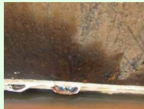
No.10 シール部状況 (平成25年9月15日撮影)
