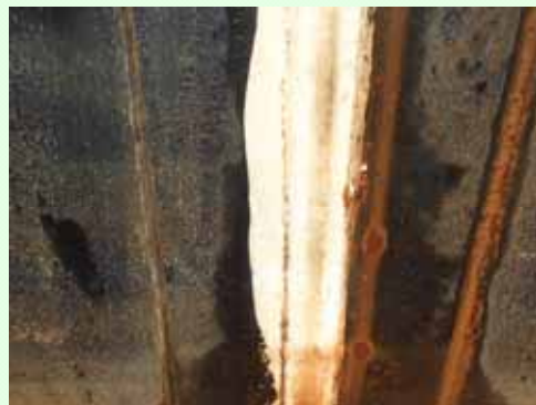
No.10 側板発錆状況 (平成25年9月15日撮影)
