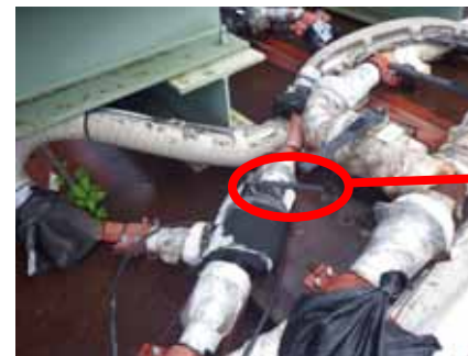
処理水貯蔵タンク元弁
