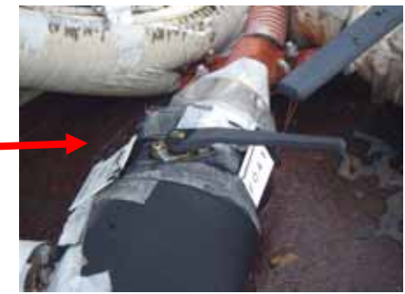
処理水貯蔵タンク元弁 (拡大写真)
