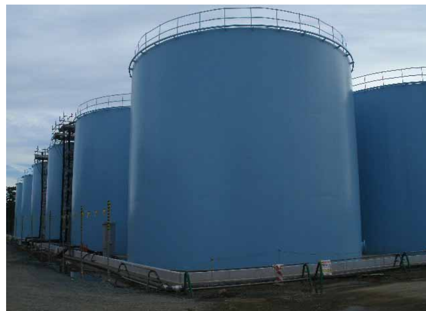
溶接型タンク
