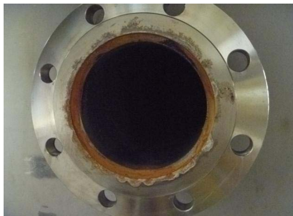
バッチ処理タンク2Aデカントノズル フランジシール面に すき間腐食有り
