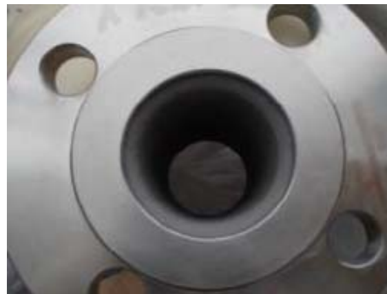
⑧供給ポンプ2出口配管フランジ
