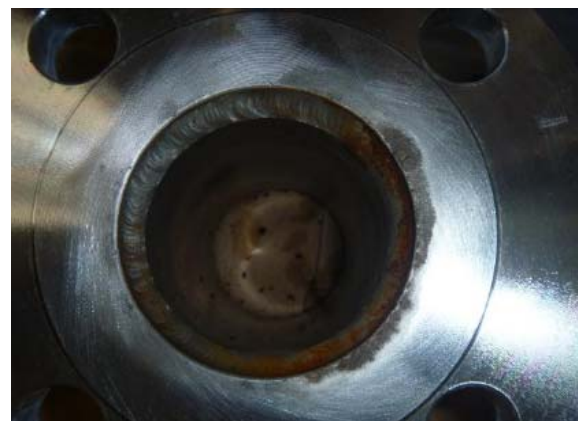
供給ポンプ1A出口配管 フランジシール面に すき間腐食有り
