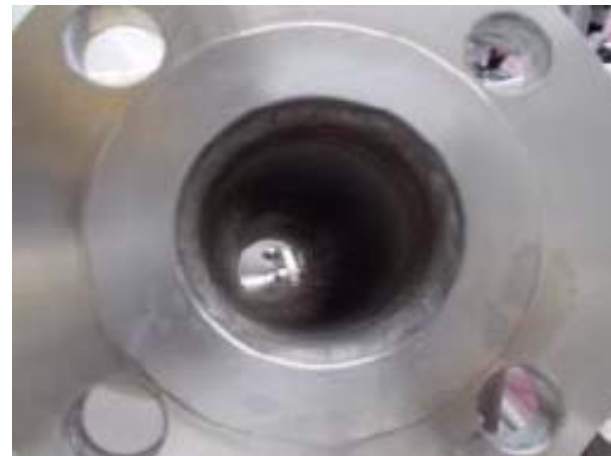
②スラリー移送ポンプ出口配管フランジ
