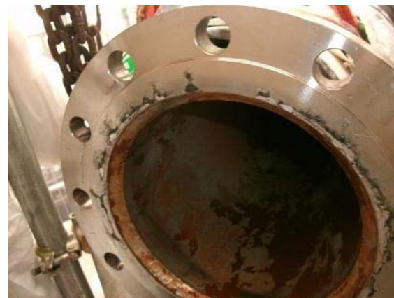
循環タンク戻り配管ノズル フランジシール面に すき間腐食有り
