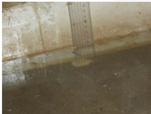
工作建屋における止水処置実施後の残水状況 (平成23年6月9日撮影)
