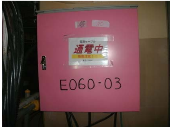
仮設分電盤N-1 (プロセス主建屋2階)
