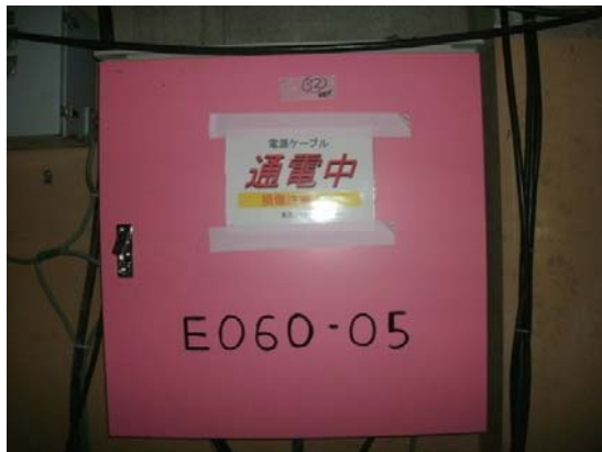
仮設分電盤N-3 (焼却・工作建屋1階)
