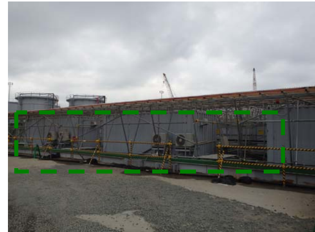
（雨水処理設備）
