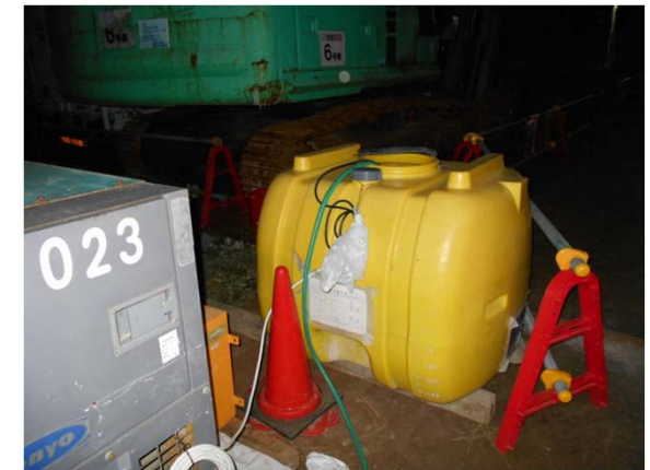
仮設プラスチックタンク
