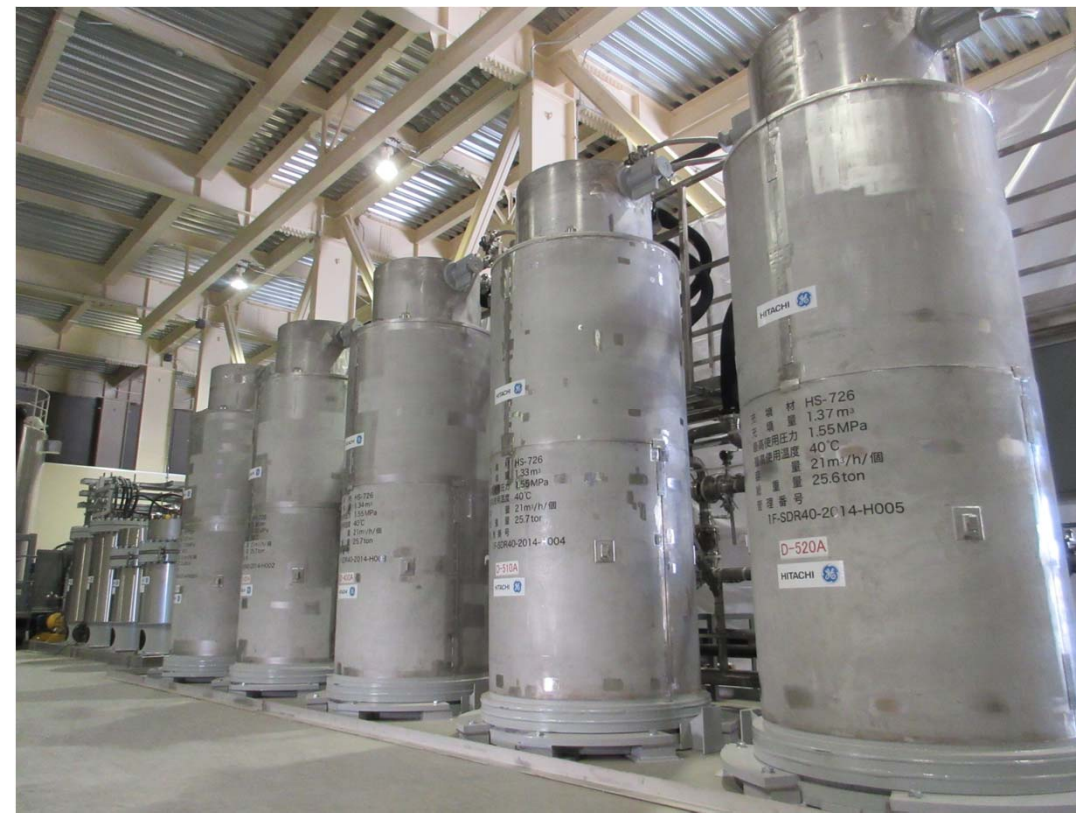
セシウム・ストロンチウム同時吸着塔
