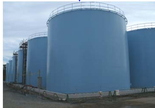
貯蔵タンク ( Sr処理水 1 )
