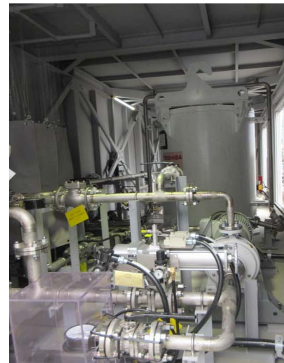
第二モバイル型ストロンチウム除去装置 (G6_C/Dタンク群) 吸着塔
