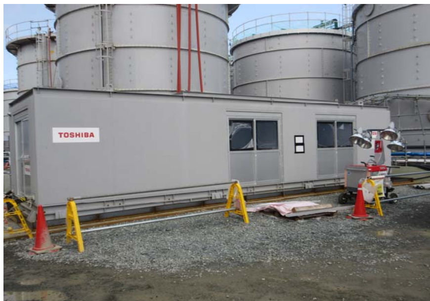
第二モバイル型ストロンチウム除去装置 (G6_C/Dタンク群) 外観
