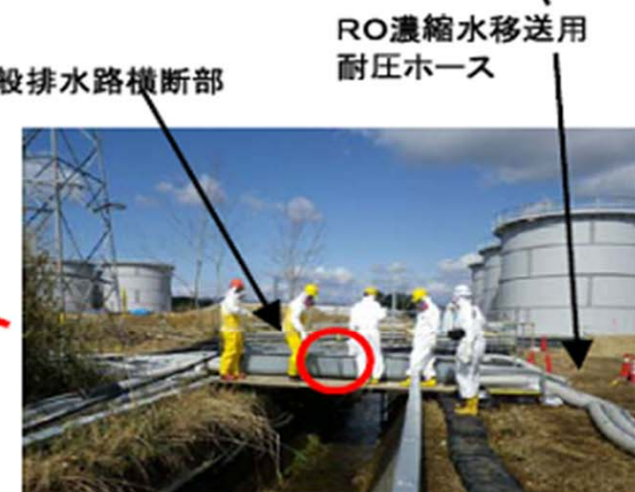
3月26日 漏えい箇所
