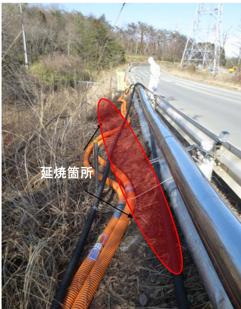
延焼の状況(道路北西側)
