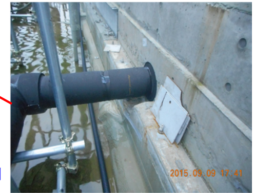
配管貫通部下部より漏えい (鉛筆1本分程度)
