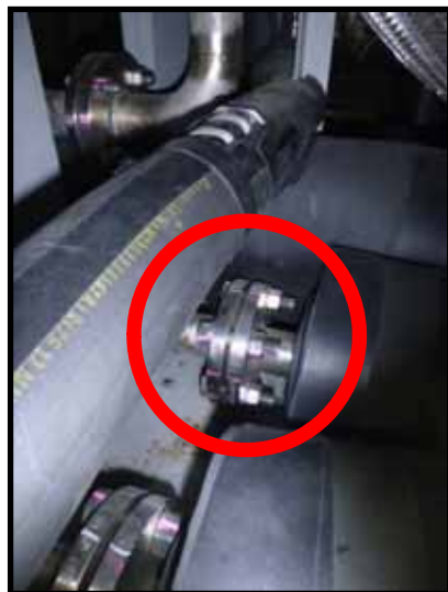
<配管フランジ>
