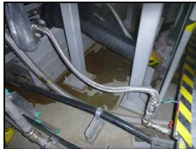
<漏えいした床面の状況>
