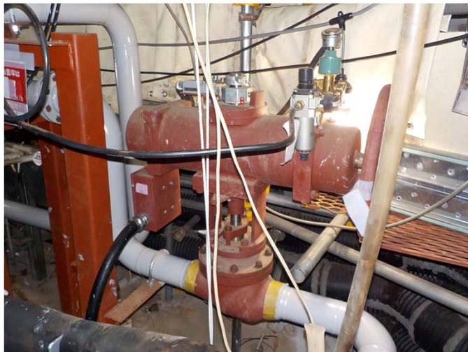
< 系統入口隔離弁(F015)現場写真 >
