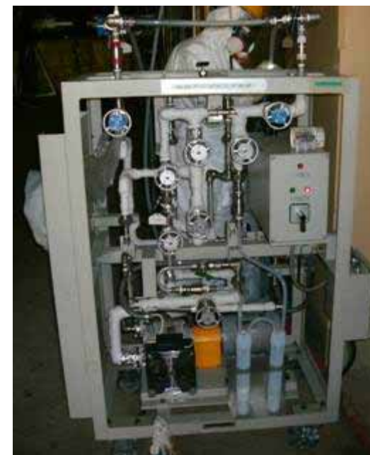
福島第一1号機原子炉格納容器仮設ガスサンプリング装置 撮影者：東京電力株式会社 撮影日：平成23年9月14日
