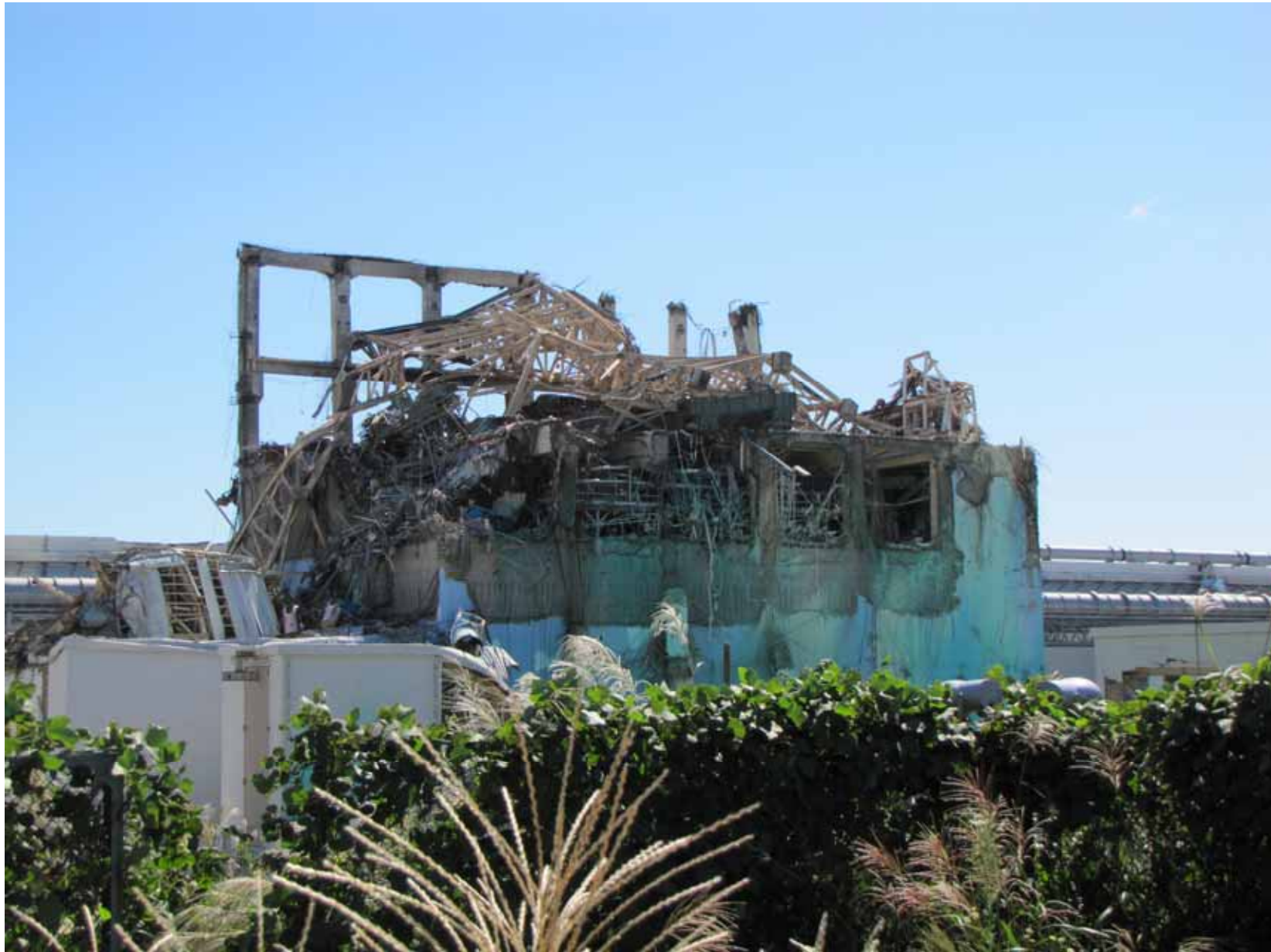
3号機原子炉建屋外観 ～ 2 ・ 3号機間西側高台から撮影～ 平成23年9月24日 当社社員撮影
