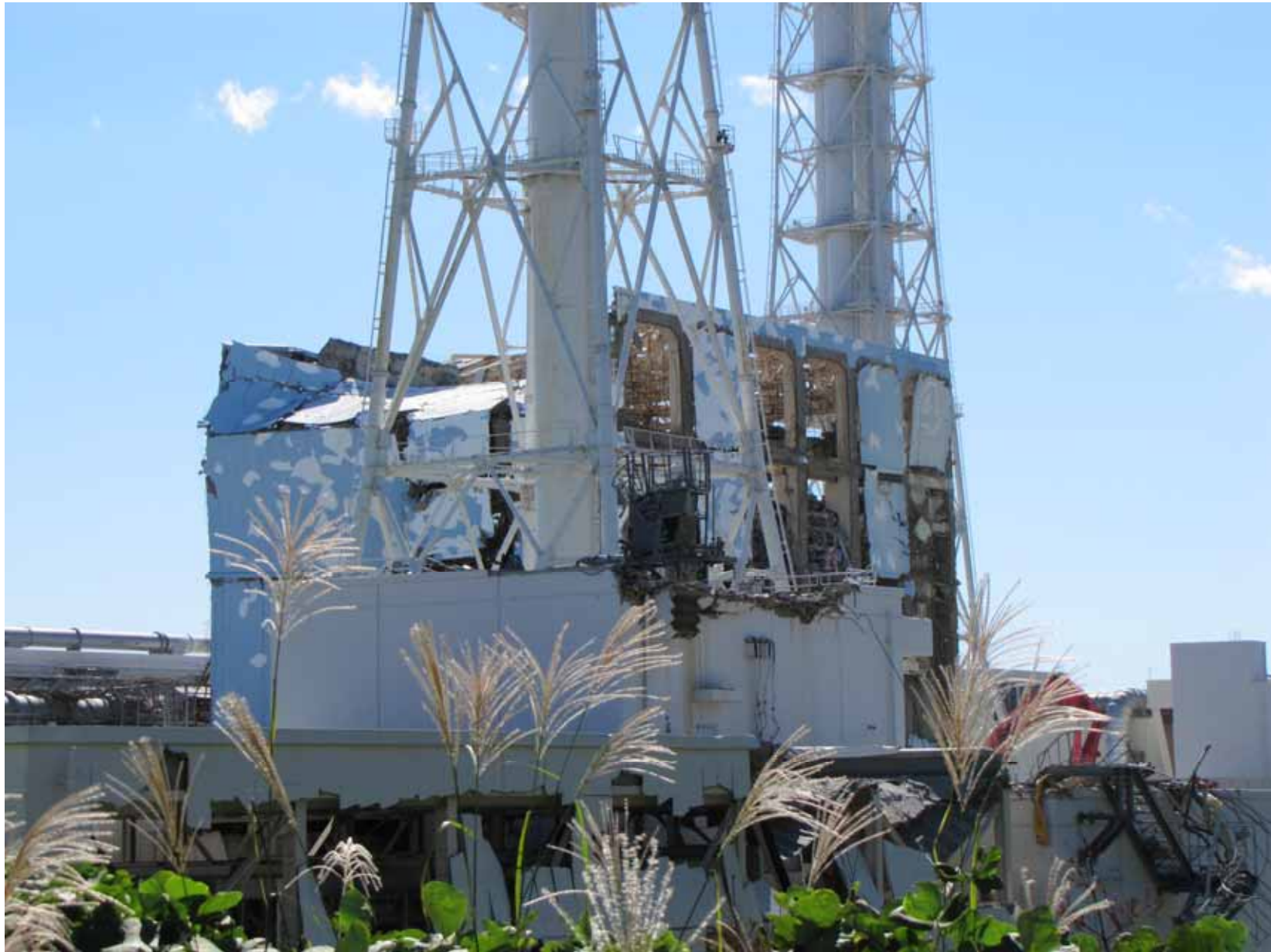
4号機原子炉建屋外観 ～ 2・3号機間西側高台から撮影～ 平成23年9月24日 当社社員撮影
