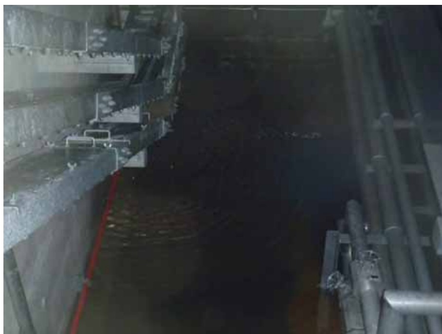
【写真】トレンチ内の水溜まりの状態
