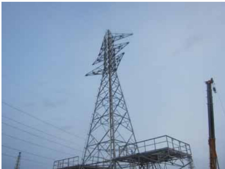
- 1 新開閉所への引き込み鉄塔 平成24年1月9日 当社社員撮影
