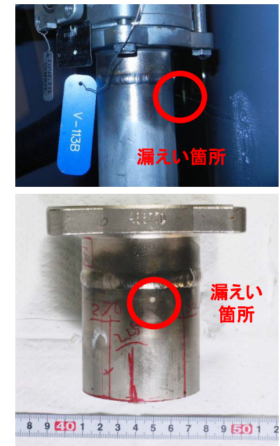
漏えい発生部
