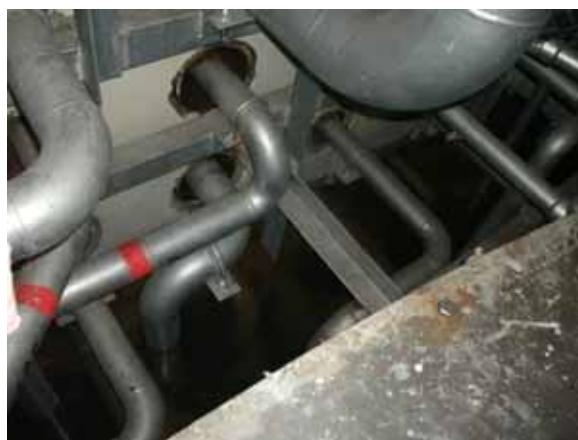
廃棄物地下貯蔵建屋 - 廃棄物処理建屋間の 配管貫通部水没状況
