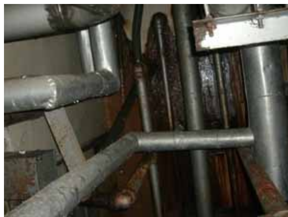
付近の流水痕確認部
