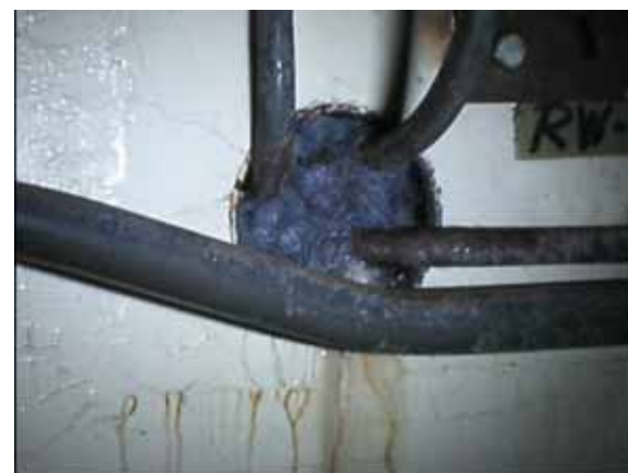
廃スラッジタンクA南壁配管貫通部 にじみ状況
