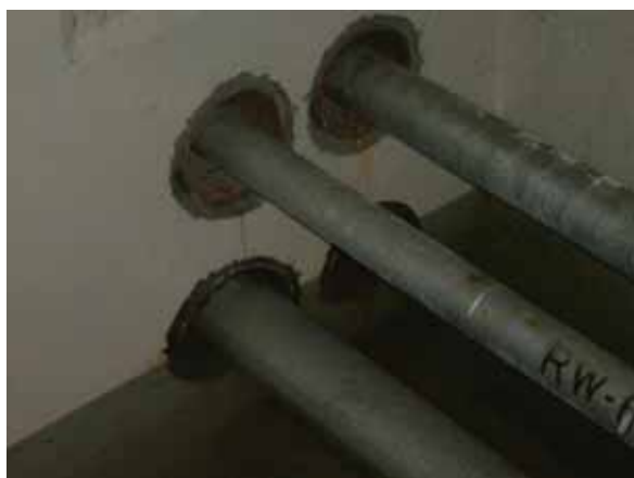
原子炉冷却材浄化系 廃樹脂貯蔵タンク室 - 廃スラッジ貯蔵タンク室間の 配管貫通部水没状況
