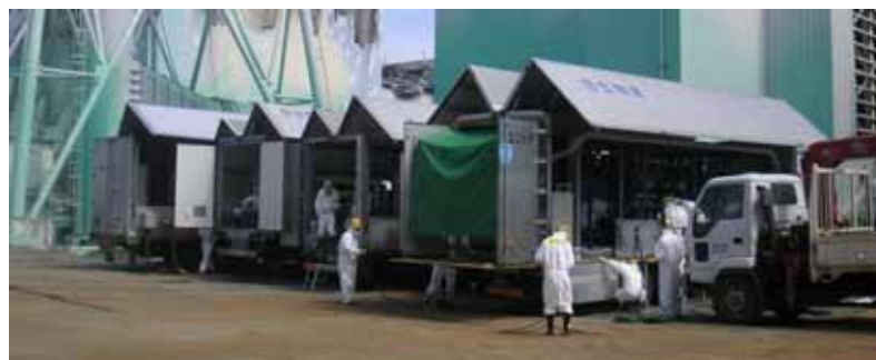
塩分除去 逆浸透膜(RO)装置
