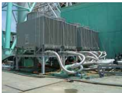
使用済燃料プール 循環冷却装置
